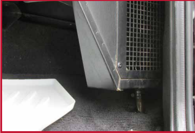
Figura 11 - Unidad HVAC de alta capacidad
